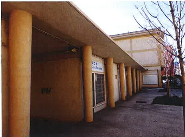
Galerie commerciale sous pilotis qui établit la liaison entre deux bâtiments ©Etudes et Planification Mairie Toulon. Février 2014
