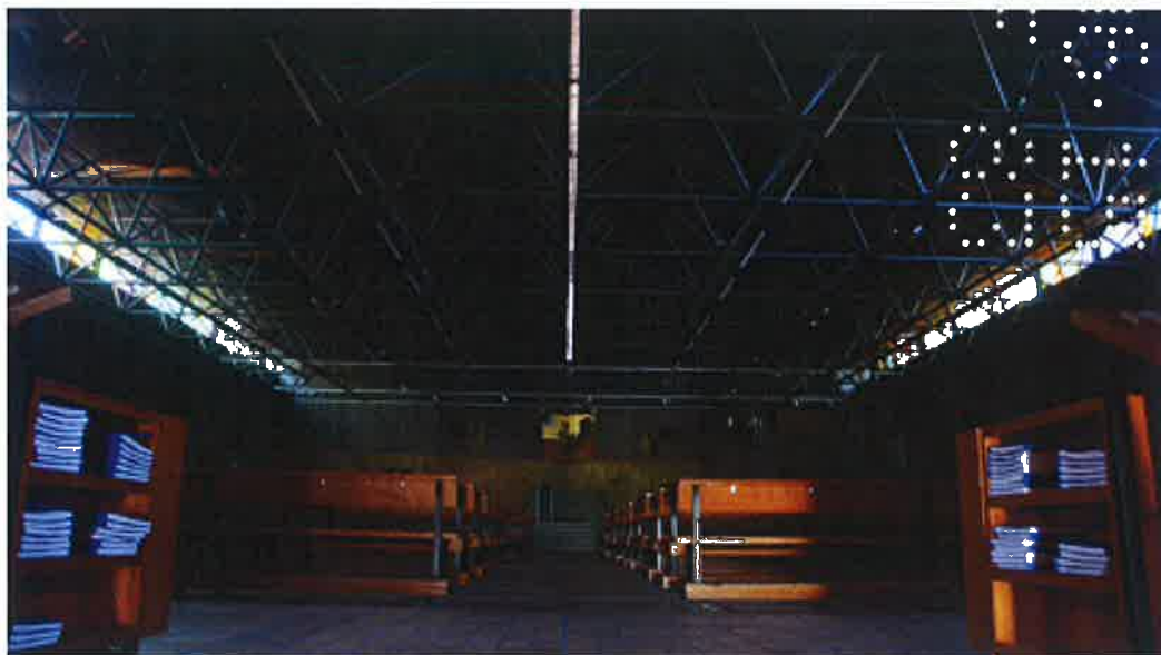
Vue intérieure, nef vers le chœur, mise en évidence de la structure métallique de la charpente. ©Claudine Bron, juillet 2013.
